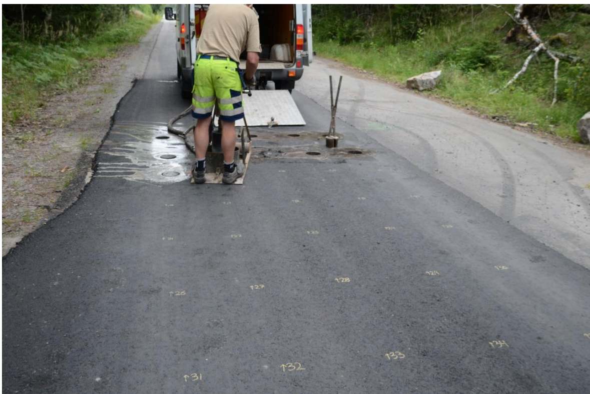
Figur 3-4 Borrkärnorna märktes med ett nummer, samt åt vilken riktning som beläggningen gjordes. (Foto: Tomas Åström, 2011)
